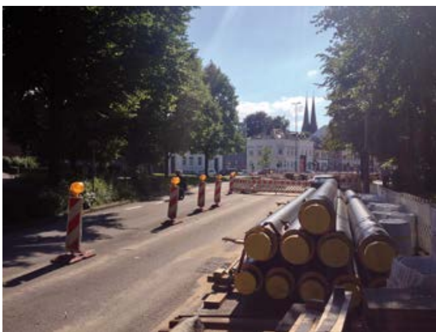
Fernwärmeleitungen in Hamburg
